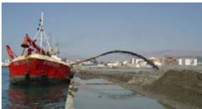
▲ Relleno de la explanada en Las Azucenas con materiales procedentes del dragado.
