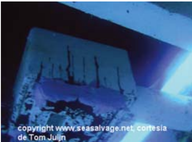
▲ Suspiro de tanque de FO.
